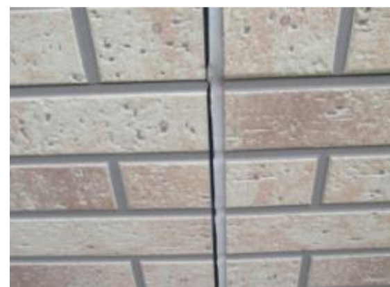
目地の劣化・破断
