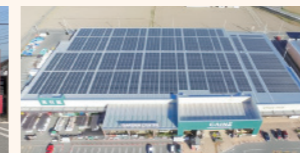
カインズ 前橋小島田店に設置している太陽光パネル
